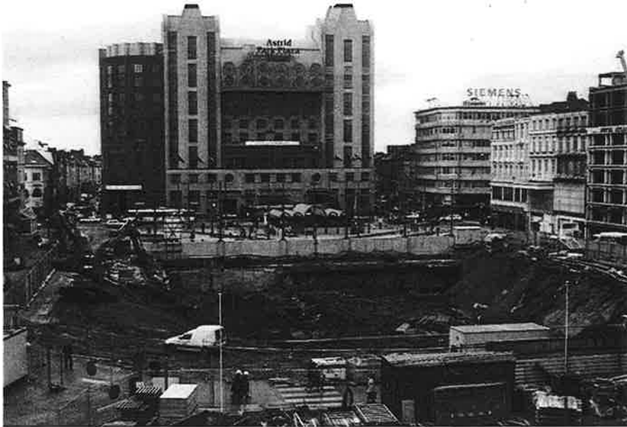
Vanuit het Centraal Station werd deze opname mogelijk gemaakt. De foto toont de diepe put voor de werkzaamheden van de hogesnelheidslijn. 28 februari 2002. Foto : Alain Janmart.
