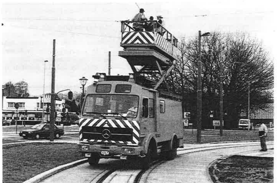
Merksem-Keizershoek. Het vast ankeren van de bovenleiding zal begin maart voltooid zijn. De bovenleidingswagen bevindt zich in de bocht naar het nieuwe eindpunt. 28 februari 2002. Foto : Alain Janmart.
